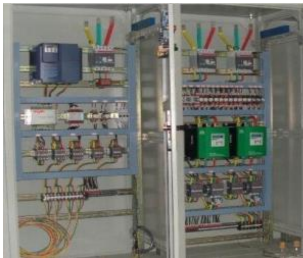
图 5-11 电控柜接线实物图
